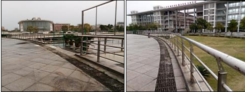
图4 地表排水沟堵塞情况
